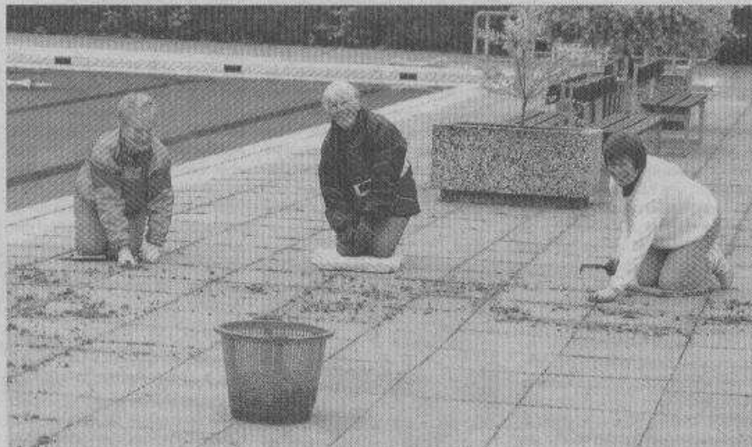
Mit vereinten Kräften wurde das Freibad fit gemacht, 1.300 Arbeitsstunden wurden ehrenamtlich geleistet.
